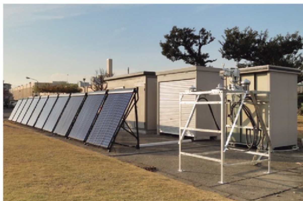
図38 太陽熱発電システム全景
